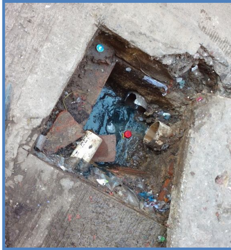
Figura 7.- Ana María Janer 3.759. Se observa una cámara cloacal precaria recibiendo el vuelco cloacal domiciliario.
