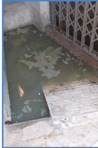
Figura 11.- Manzana 10 Casa 76. Se observa líquido cloacal en el ingreso a la vivienda. De acuerdo a lo que manifiesta el dueño de la vivienda, la situación lleva más de un mes y es el resultado de una obstrucción de una cámara del pasillo que genera el retorno de líquido cloacal hacia el interior de la vivienda.
