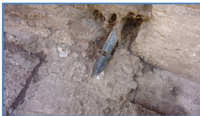
Figura 5.- Ana María Janer 3.759. Se observa una manguera de agua cortada.
