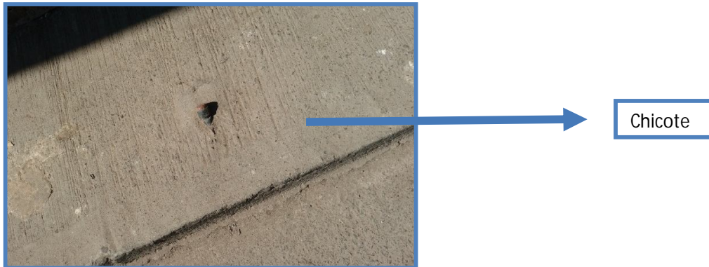
Figura 3.- Ana María Janer 3.734. Se observa que el chicote de agua no se encuentra conectado a las viviendas.
