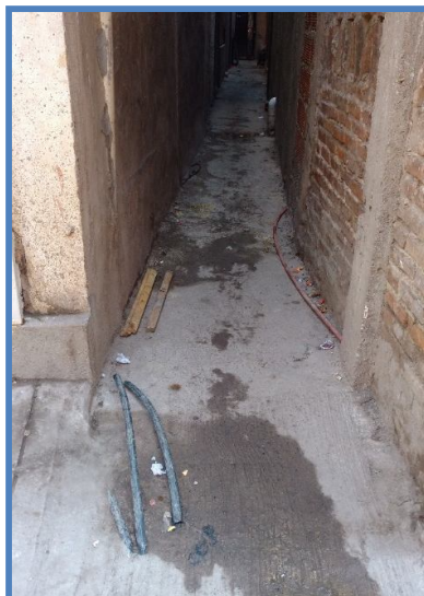
Figura 6.- Ana María Janer 3.787. Se observan en el ingreso al pasillo tres chicotes de agua no conectados a las viviendas. De acuerdo a lo que manifiestan los vecinos este pasillo se inunda frecuentemente.
